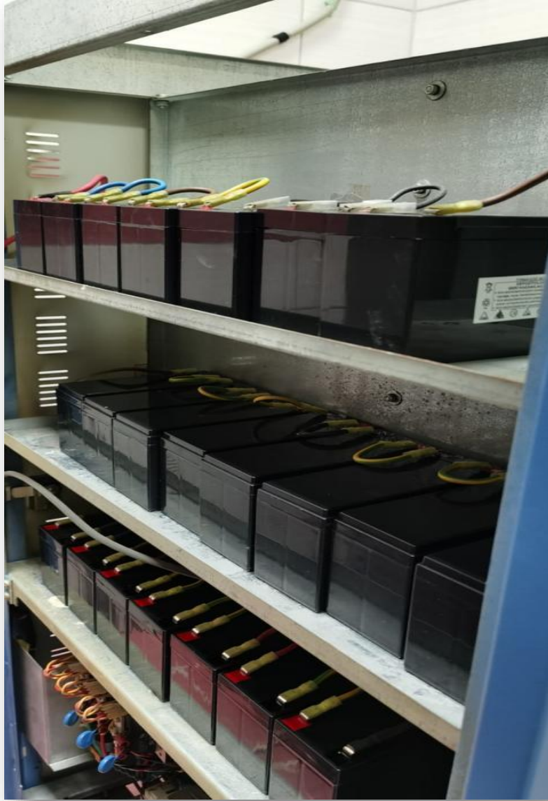
Görsel: Muhtelif İşler Kapsamında Yapılan Alım Örnekleri-UPS Akü Değişimleri
